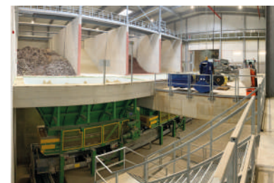
Inbetriebnahme der neuen Aufbereitung Instalación de la nueva planta de preparación
